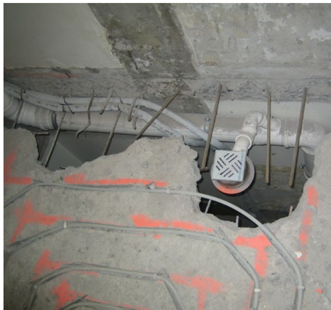
Mynd 15. Gólfhitalagnir fyrir heitt vatn.
