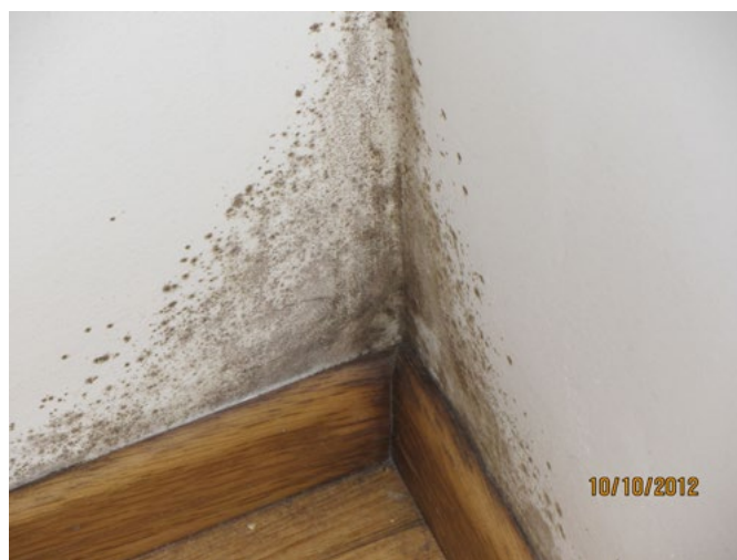
Mynd 8. Mygla og raki í horni við útvegg.
