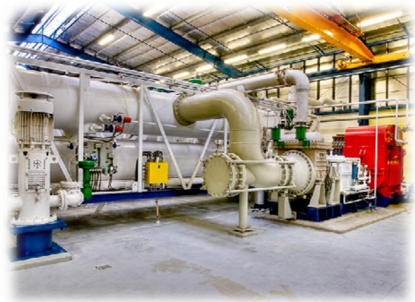
Mynd 6 1,2 MW Ormat Ísopentan vél í orkuveri 4
