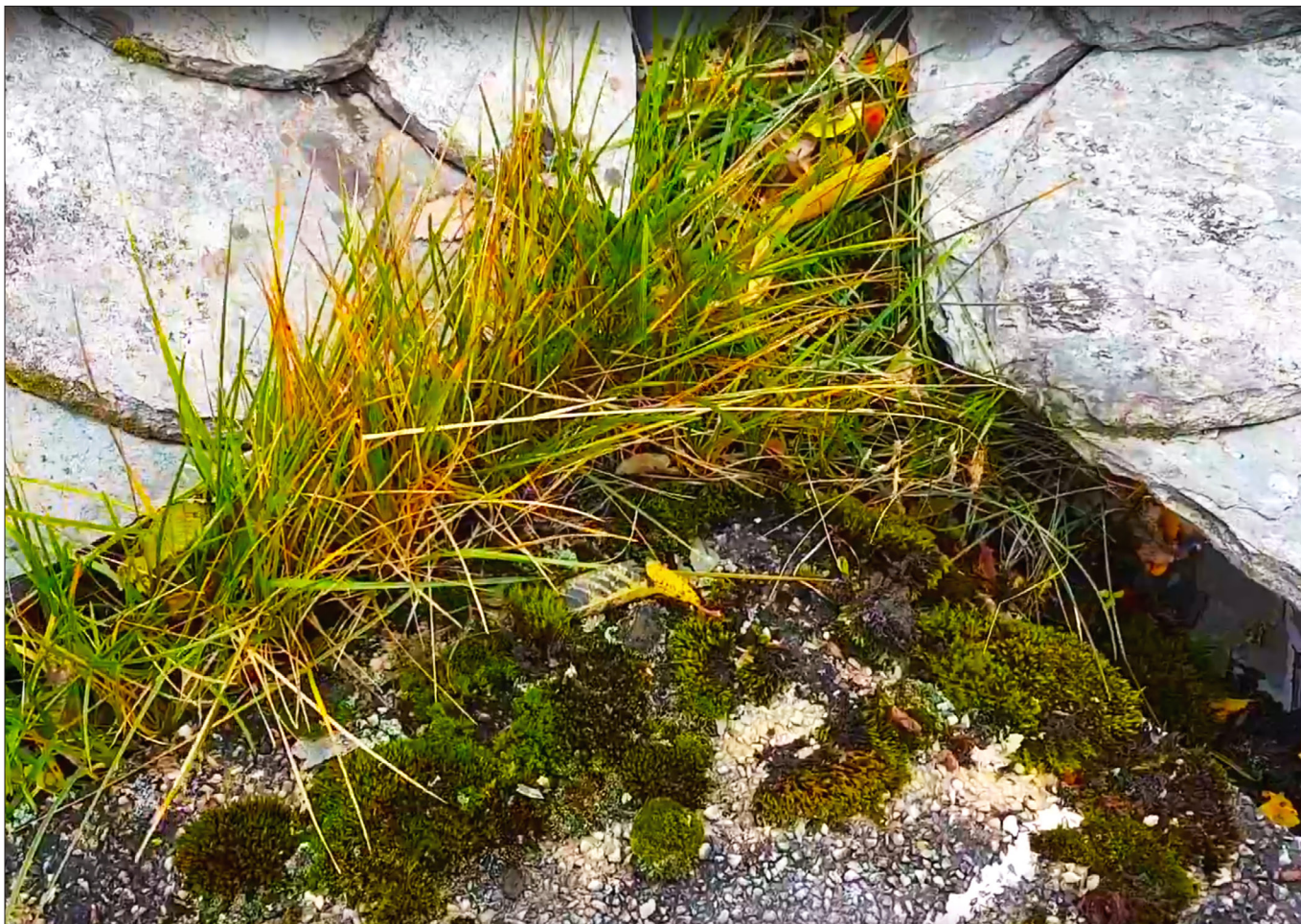
Mynd 6. Grasi vaxin stífla í rennu á einbýlishúsi í miðbæ Reykjavíkur.
