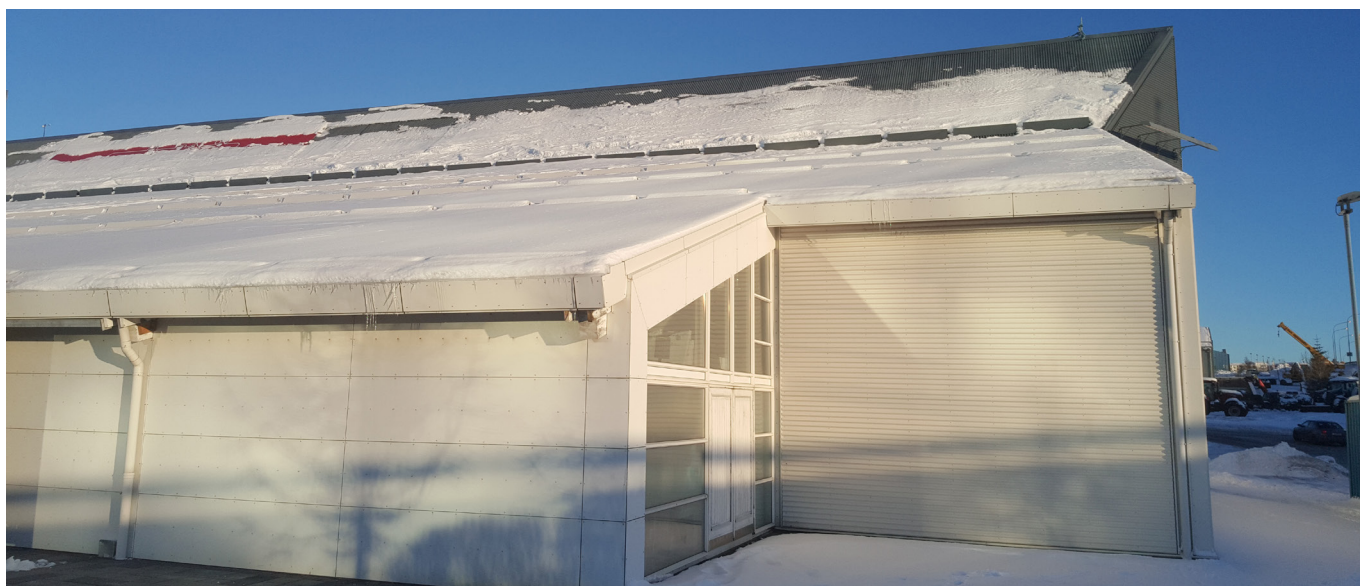
Mynd 11. Á myndinni sést hvernig hvítu þakgrindurnar á stórum þakfleti sem sýndar eru á mynd 11 koma í veg fyrir færslu á þykku lagi af snjó sem fallið hefur á þakið. Á grá þakfletinum þar sem hallinn er mun meiri má sjá hvernig snjórinn hefur skriðið niður og stoppað á grindarröð þess þakflatar.
