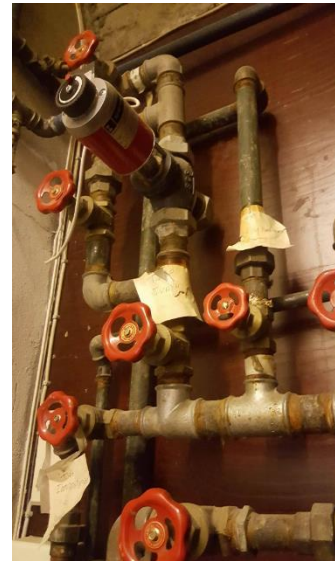
Mynd 20 hluti af tengigrind gólfhita. Mótrolki sést á mynd.
