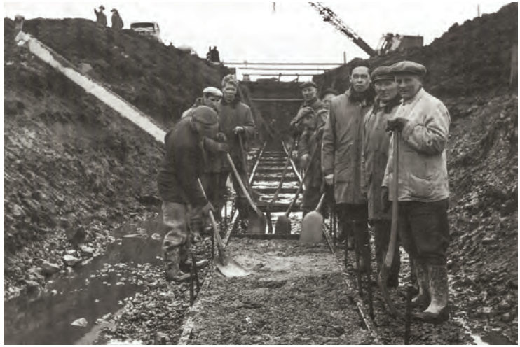
Botnplata steipt í Kringlumýrarræsi. Þriðji maður frá hægri er Gunnar Sigurðsson verkfræðingur.
