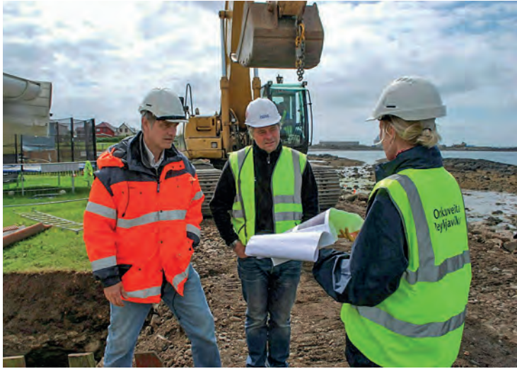
Íris Þórarinsdóttir verkefnisstjóri (t.h.) spáir í framkvæmdir á Akranesi með staðarstjóra Ístaks, Árna Geir Sveinsyni, og effirlitsmanni Verkis, Jóhanni Má Hektorssyni. Í baksýn beltisgrafa.
