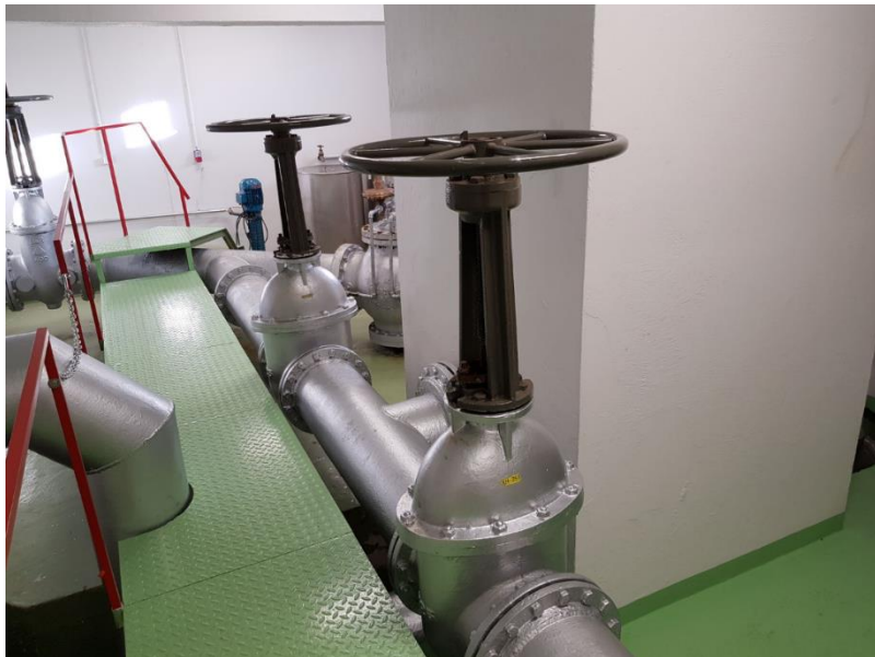
Mynd 23: Handvirkir lokar á lögnum sem liggja inn í vatnsgeymirinn í Litluhlíð, mannvirki nr.112 [21]
