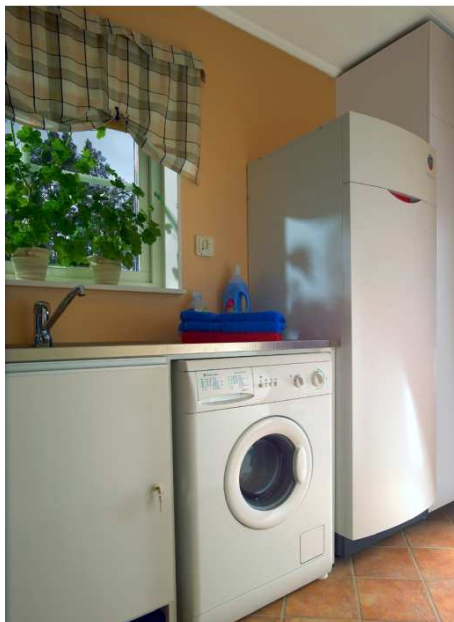
Mynd 6.3: Uppsett varmadæla í þvottahúsi.
