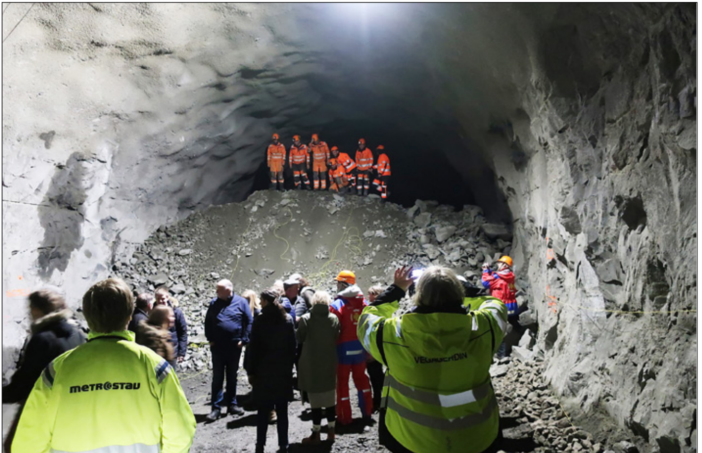
Starfsmenn Metrostav stilla sér upp fyrir myndatöku eftir hátíðarsprengingu í Dýrafjarðargöngum 17. apríl.
