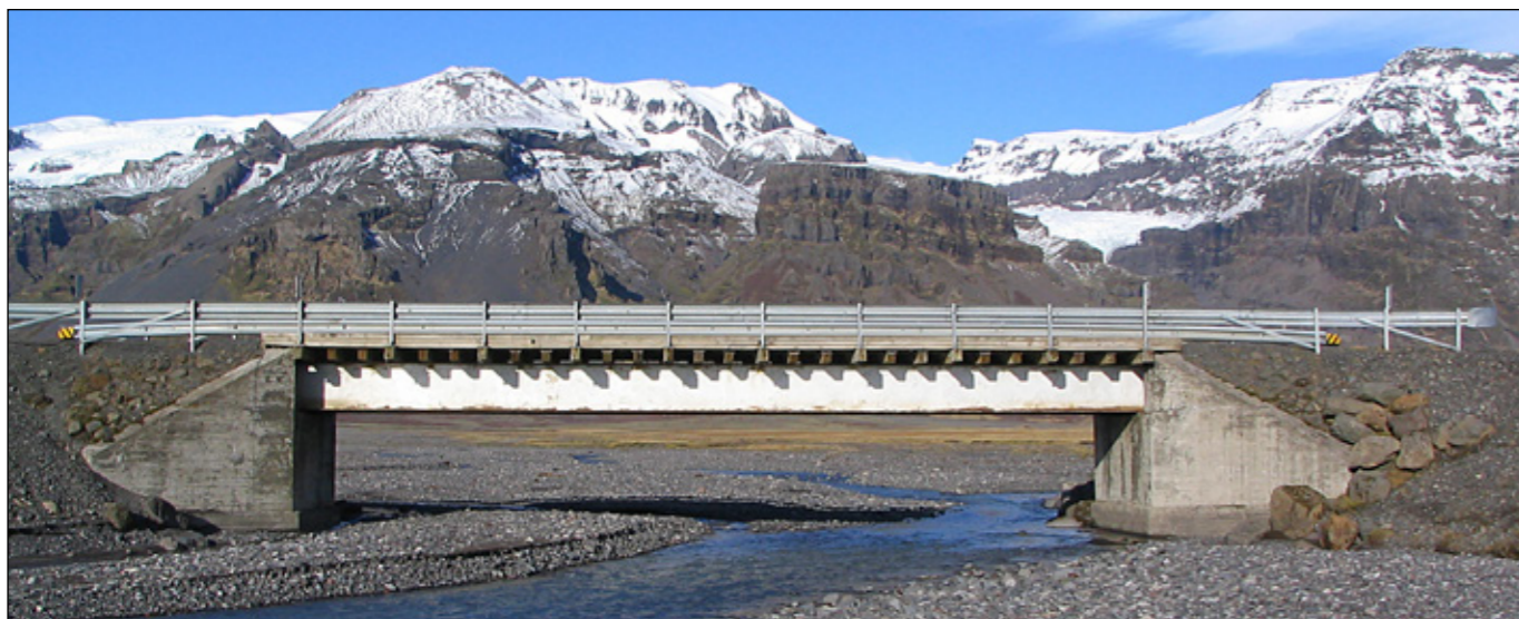
Hringvegur (1), einbreið brú á Stigá í Öræfum. Á þessu ári er verið að byggja nýja brú á þessum stað og eins við Hólá sem er skammt frá.
