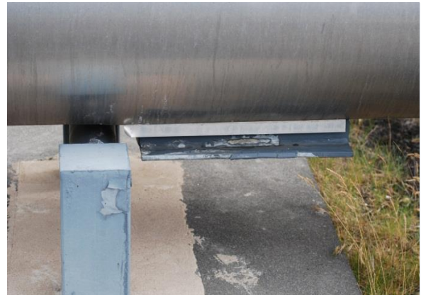
Mynd 8.6 Lögn sem svipst hefur af undirstöðu.
