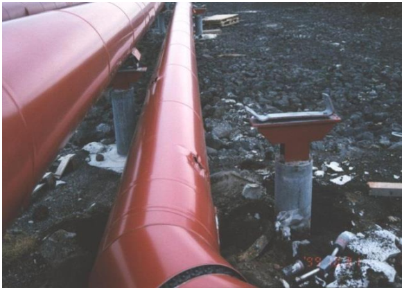
Mynd 8.5 Lögn sem svipst hefur af undirstöðu.
