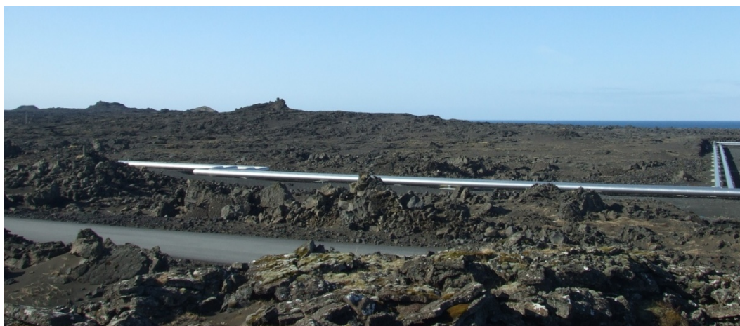
Mynd 30.3 Gufulagnir við Reykjanesvirkjun. Ljósmynd: Björn H. Barkarson 2008.
