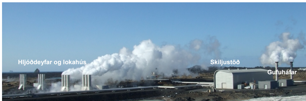
Mynd 8.7 Núverandi skiljustöð. Gufuháfar hægra megin við skiljustöð og skiljuhljóðdeyfar og lokahús vinstra megin.
