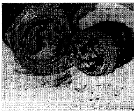
Mynd 4 Bútur úr inntakslögn úr fyrsta húsinu sem skoðað var
