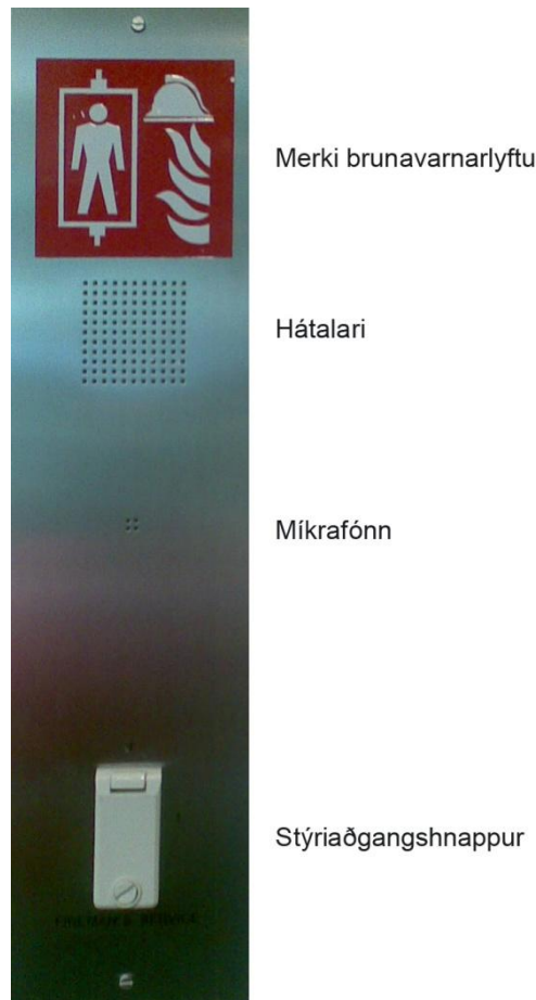
Mynd 4: Dæmi um samskiptakerfi staðsett í brunavarnarlyftu.
