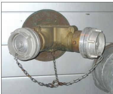
Mynd 5.59 Inntak fyrir vatnsúðakerfi.
