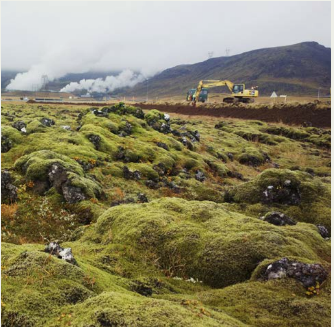
Mynd 6. Við byggingu gashreinsistöðvar á Hellisheiði á haustdögum 2013 var hluti af lagnaleið færður úr óröskuðu hrauni í raskað land í vegkanti. Ljósmynd: Magma Magnúsdóttir.
