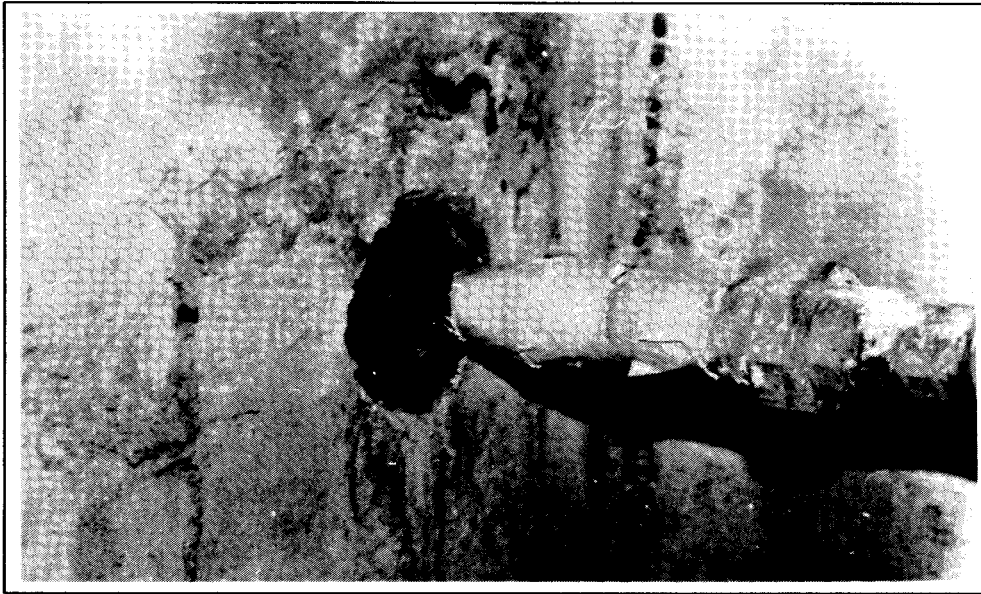
Mynd 9.5.4 Skemmd á röri sem fer í gegnum steinvegg
