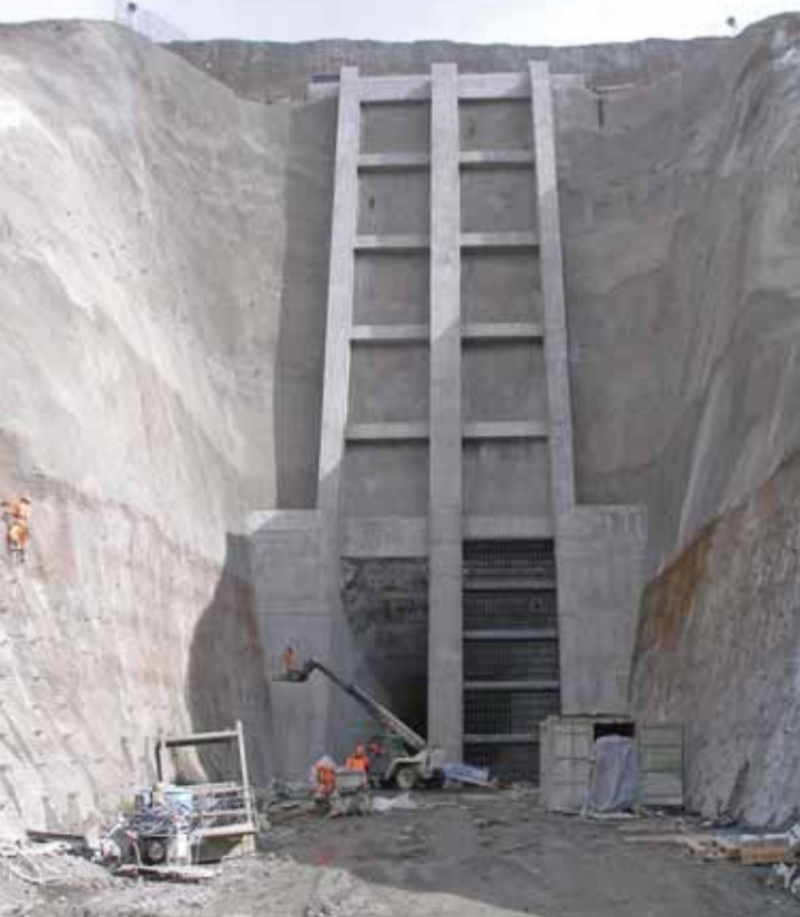
Inntak aðrennslisganga kárahnjúkavirkjunar er 50 m hátt mannvirki
